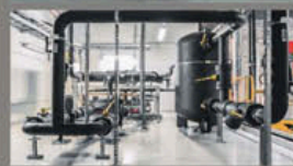
امکان تامین کلیه شیرآلات مرتبط با شبکه تولید، توزیع بخار و برگشت کندانس به موتورخانه The possibility of supplying all the valve related to the steam generation and distribution network and condensate return to the boiler room
