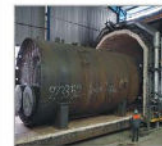
کوره عملیات حرارتی و تنش زدایی °C 1100 با حجم 500 متر مکعب و دقت دمایی °C ± 5 Post-weld heat treatment furnace 1100 °C with a volume of 500 m³ and temperature accuracy of +/5 °C
